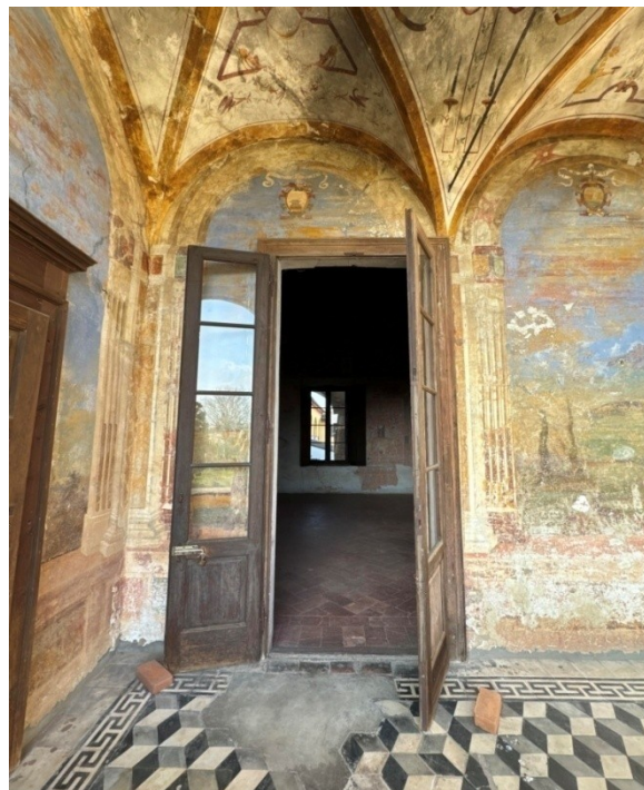
Figura 47: dettaglio dell'affresco compromesso dall'apertura della porta, Palazzo Oldofredi-Tadini Botti.
