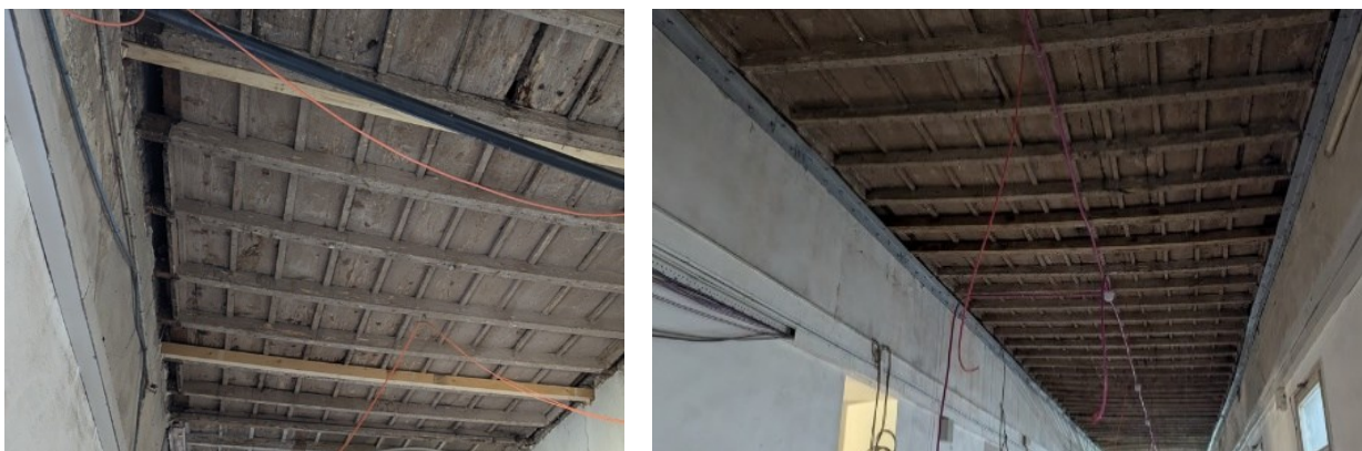
Figura 98: appoggio degradato dei travetti del sottotetto del solaio in legno (a sinistra) e nuovo cordolo metallico inghisato alla muratura e connesso ai travetti (lavori di Studio Calvi BEAM BEAM)
