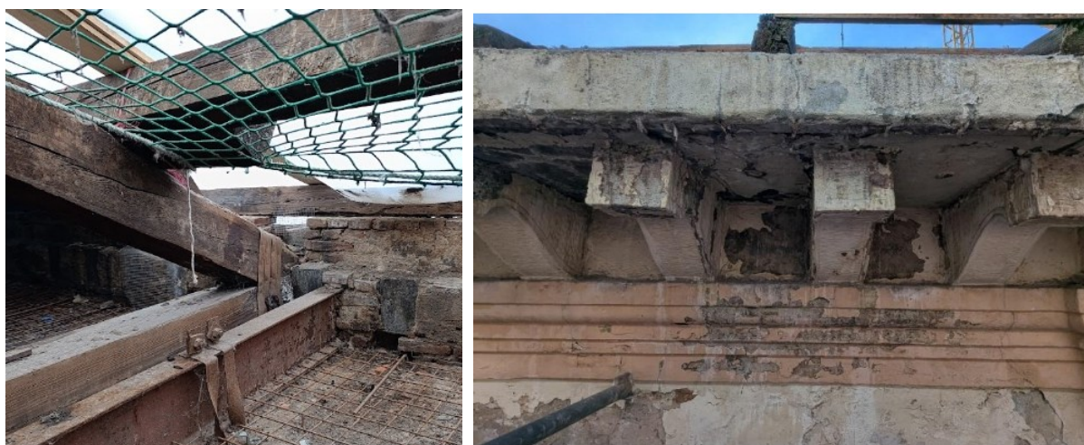
Figura 77: a sinistra, carenza di spazio per il posizionamento di putrelle in acciaio a rinforzo di una capriata dell'Ex Caserma Sacchi di Pavia. A destra, vista esterna dell'ostacolo causato dalla presenza delle mensole in calcestruzzo adiacenti alla capriata.
