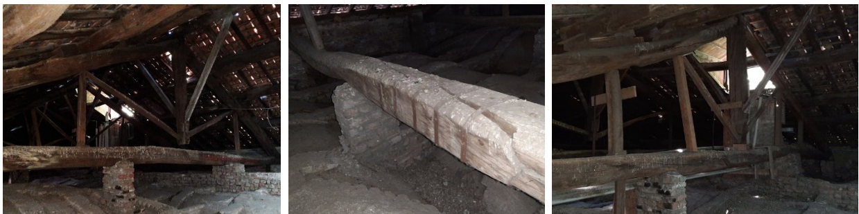
Figura 94: interventi di rinforzo per una catena da sostituire e manto di copertura non impermeabilizzato (foto di Studio Calvi BEAM BEAM)
