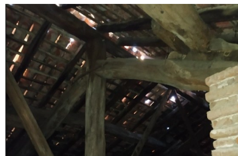
Figura 36: vecchia e inefficace protezione delle capriate della copertura del Palazzo San Felice a Pavia
