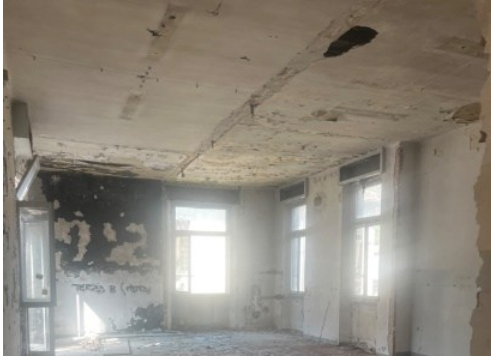
Figura 106: solai in laterocemento con sfondellamento in atto (lavori di Studio Calvi BEAM BEAM)
