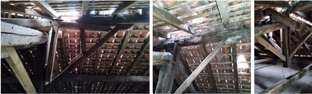
Figura 93: porzioni della trave di colmo ammalorate e capriata da sostituire (foto di Studio Calvi BEAM BEAM)
