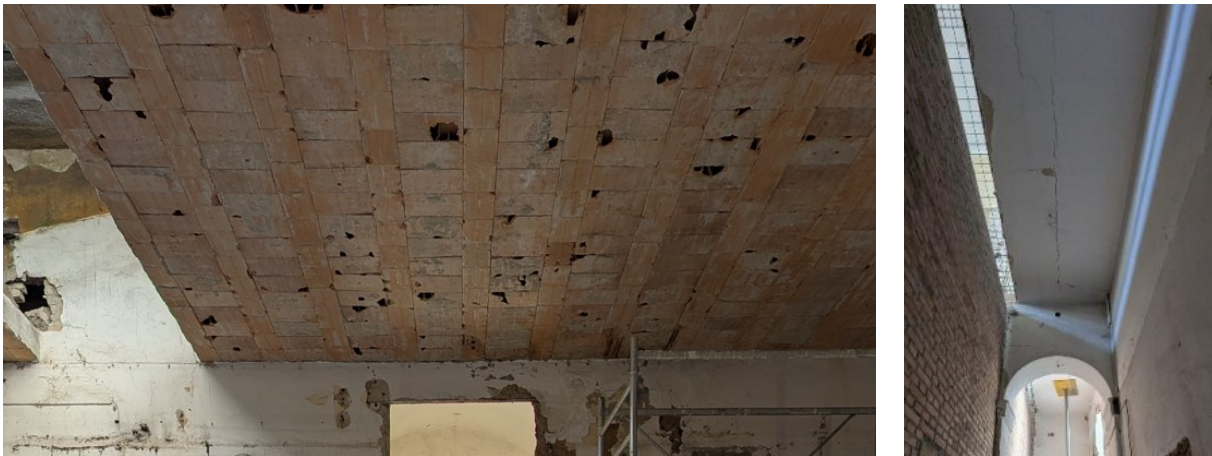
Figura 123: solaio in laterocemento con necessità di rinforzo a flessione e solaio in putrelle e pignatte con sfondellamento in atto da demolire
