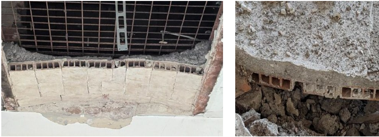
Figura 23: solaio in putrelle e tavelline con struttura rinvenuta durante le demolizioni della Ex Caserma Sacchi a Pavia. A destra materiali del solaio crollati durante le demolizioni, si nota lo spesso strato di malta che chiude l'intradosso.
