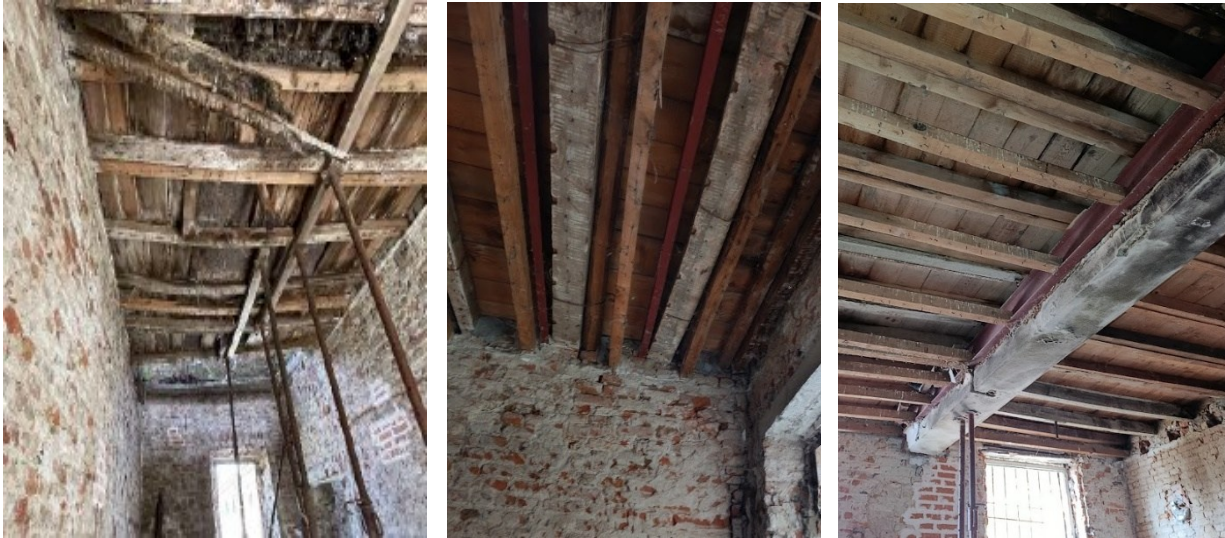
Figura 134: a sinistra solaio in legno parzialmente crollo, al centro travi in legno/acciaio affiancate a quelle esistenti, a destra rinforzo della trave maestra con profili in acciaio affiancati durante gli interventi del 2008
