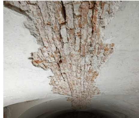
Figura 45: lesioni in chiave di una volta a botte con separazione di materiale rinvenute durante i sopralluoghi dell'Ex Caserma Sacchi di Pavia.
