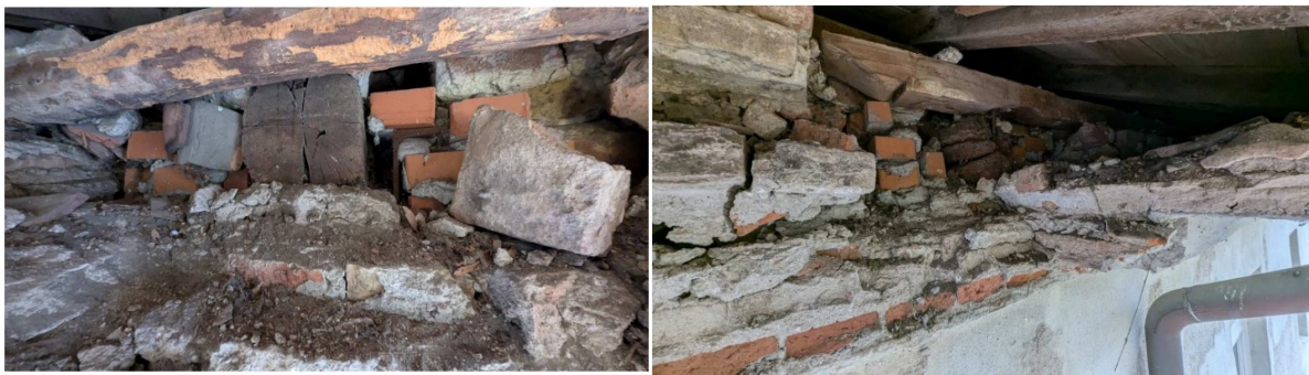
Figura 78: viste delle lastre della gronda in pietra nella zona del crollo del Palazzo San Felice di Pavia. Si notano le putrelle a C inserite senza un'approfondita conoscenza della struttura)
