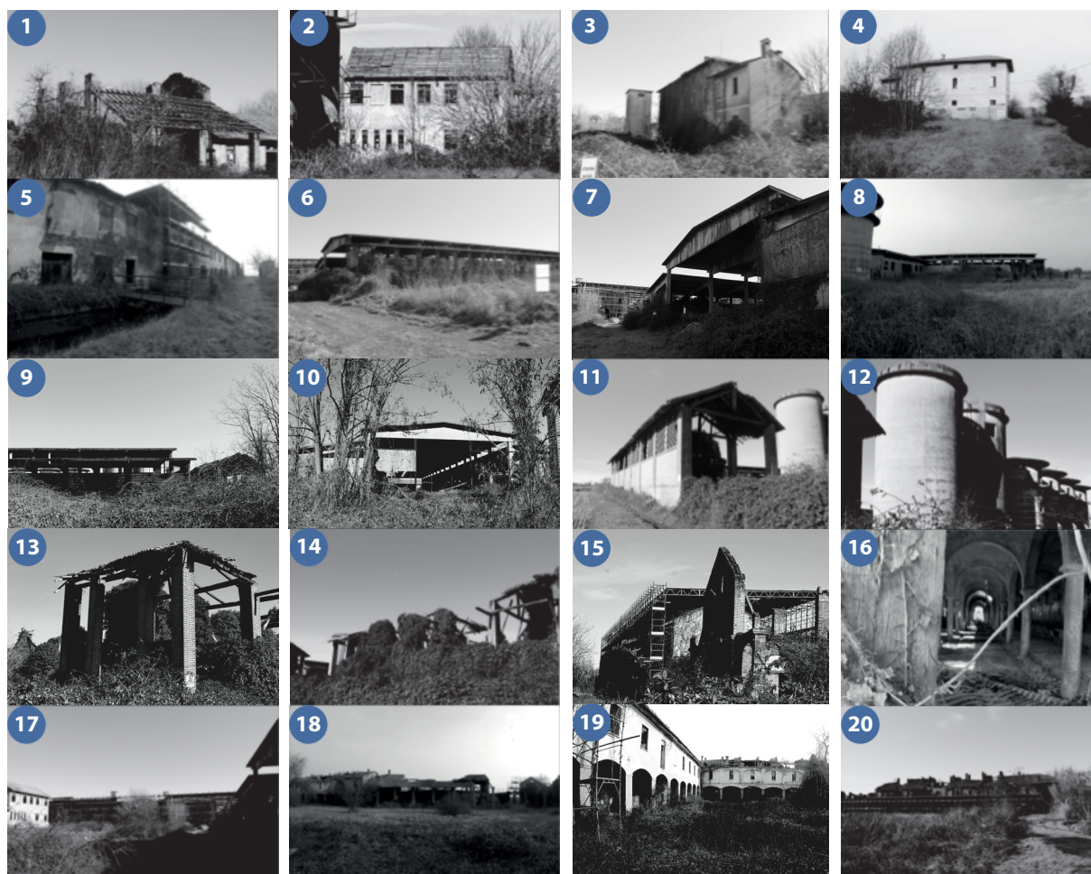
Fig. 58 Abaco fotografico dei degradi e dei dissesti strutturali
